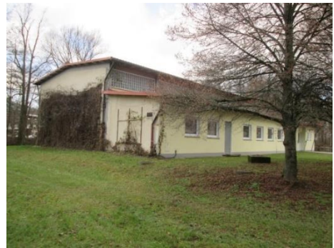
Abb. 70 Turnhalle in baulich schlechtem Zustand
